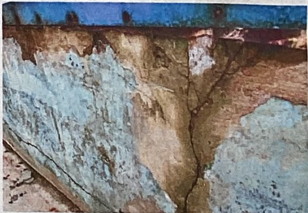
Dicke Risse im Beton zeigten sich, nachdem die Freibad-Interessengemeinschaft die Folie vom Becken des Bürgerbads in Spenge entfernt hat.
